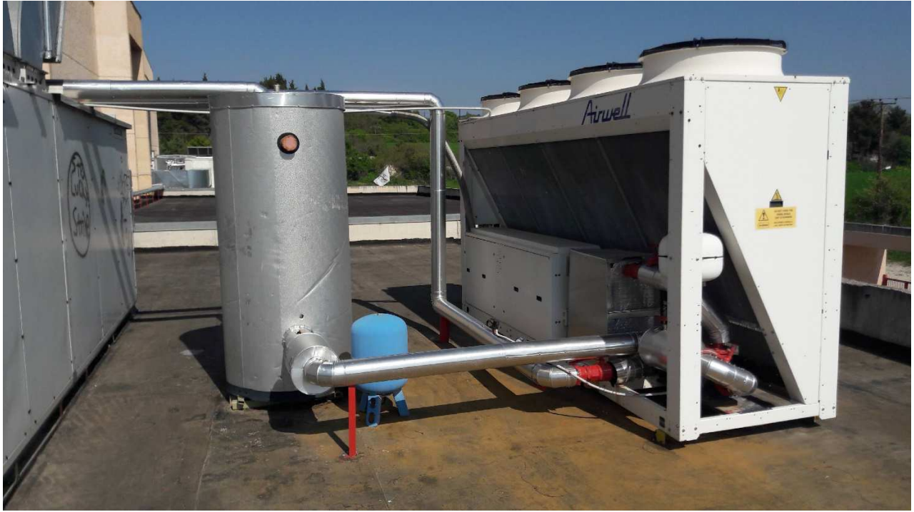
Εικόνα 4: Σημείο εγκατάστασης των νέων δικλιδών απομόνωσης στο δίκτυο της 1ης ψυκτικής μονάδας
