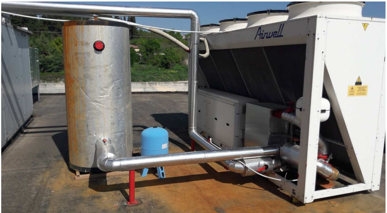
Εικόνα 3: Σημείο εγκατάστασης των νέων δικλιδών απομόνωσης στο δίκτυο της 2ης ψυκτική μονάδας
