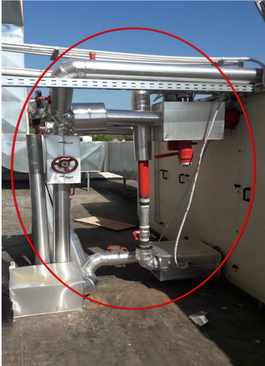
Εικόνα 1: Σημείο ανακατασκευής δικτύου και εγκατάστασης των νέων δικλείδων απομόνωσης στην 1η Κλιματιστική Μονάδα
